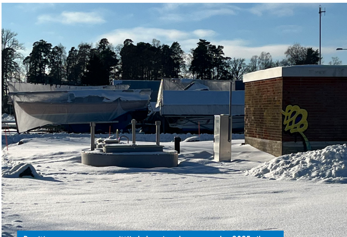
Pursittien pumppuasema uusittiin kokonaisuudessaan vuoden 2025 aikana.
