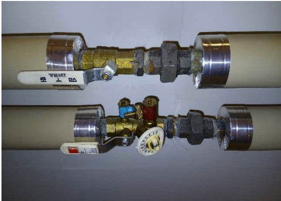
Kuva 60 Uusitut linjasäätö- ja säätöventtiilit
