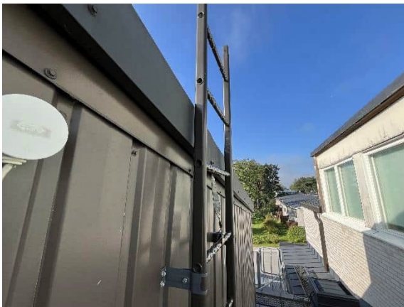
Kuva 57 Korkean osuuden katolle nousta IV-konehuoneen katon kautta. Tikkaat on asennettu liian lähelle räystästä ja niistä puuttuu yläpään käsijohteet.
