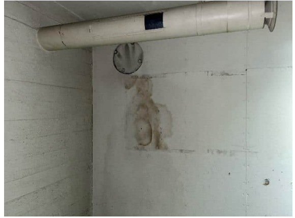
Kuva 30 Entisen VSS:n suojahuoneen 13 maanvastainen seinä on verhoiltu puukuitulevyllä. Levyssä oli putken kohdalla kosteuden ja ilmanvutojen jättämiä jälkiä.
