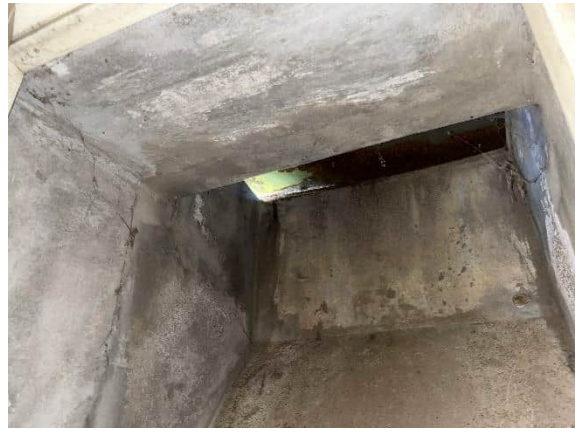
Kuva 32 Suojahuoneeseen 5 johtavan kuilun luukku ei ole tiivis.
