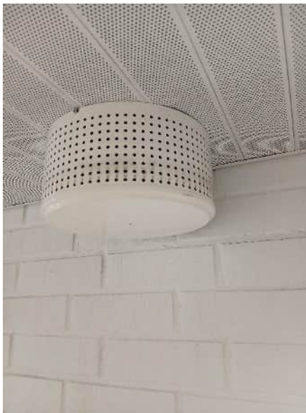
Kuva 71 Valokuvissa erimallisia tuloilmahajottajia.
