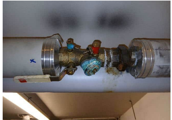
Kuva 61 Vanha vuotava linjasäätöventtiili
