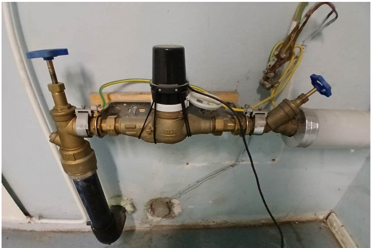
Kuva 64 Tonttijohto ja vesimittari
