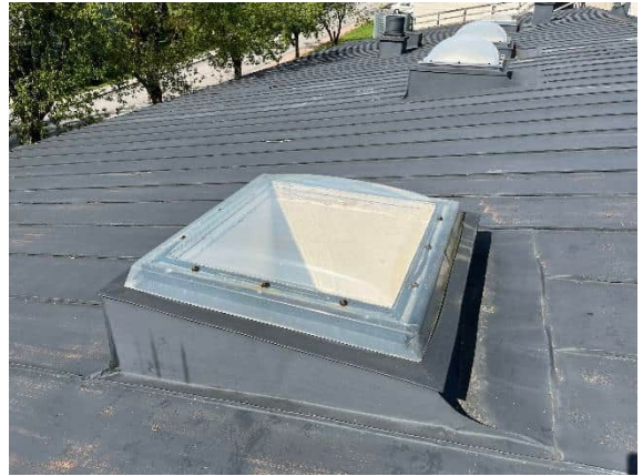
Kuva 56 Matalan osuuden kattoikkuna. Viereisen vesikatteen maalipinta on kulunut. Paikoin havaittiin myös ruostuneita kohtia
