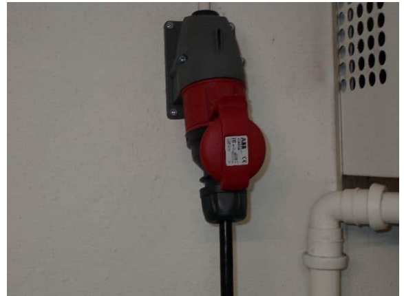
Kuva 93 Kolmevaiheinen pinta-asennettu pistorasia
