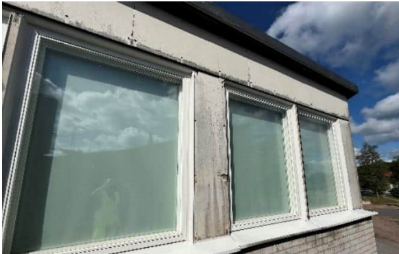
Kuva 2 N01. Julkisivujen kuitusementtilevyt sisältävät asbestia.
