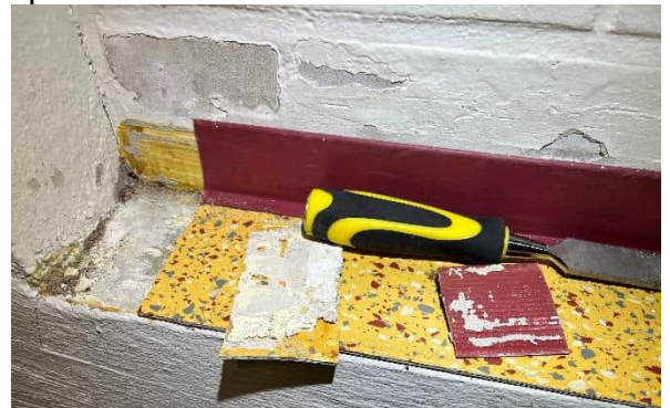
Kuva 7 N06. Käytävä 101. Keltainen, kirjava muovimatto sisältää raskasmetalleja (sinkki). Ei sisällä DEHP:iä.
