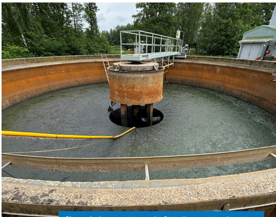
Skeppsholmen reningsverks försedimenteringsbassäng
