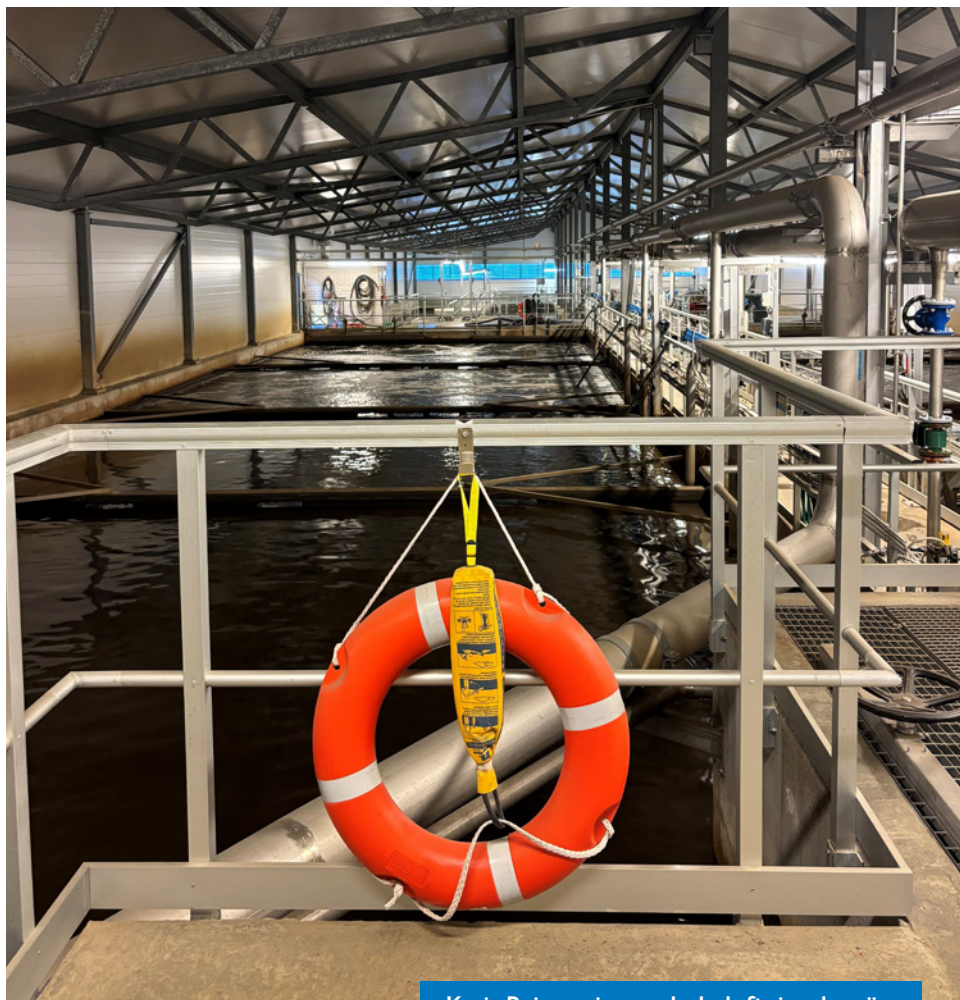
Karis Pojo reningsverks belüftningsbassäng
