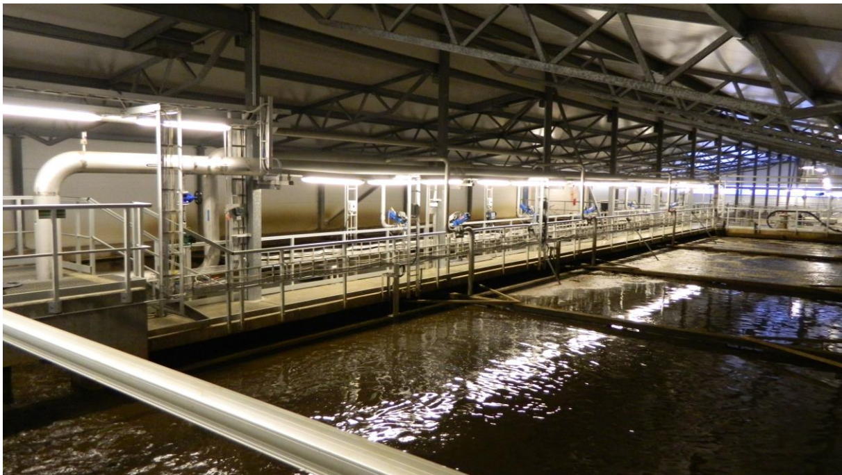
Luftningsbassänger vid Karis-Pojo reningsverk
