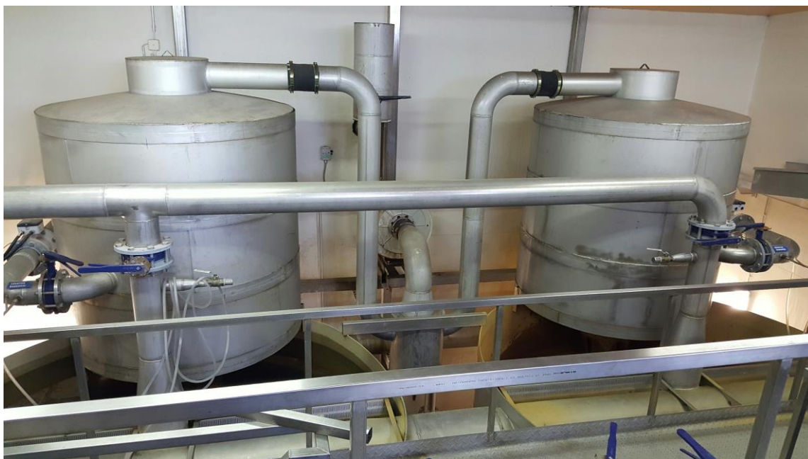
Filterteknik vid Landsbro vattentäkt
